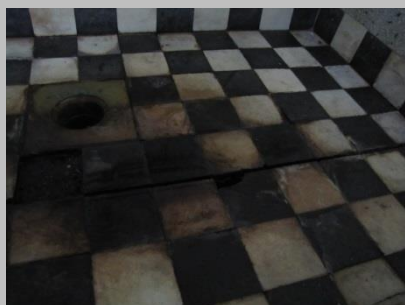
Aanrecht en betegelde gootsteen zijn niet meer intact
