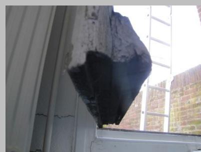
Onderzijde ramen nooit onderhouden
