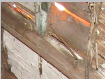
Dakbeschoot niet intact, pandekking onvoldoende
