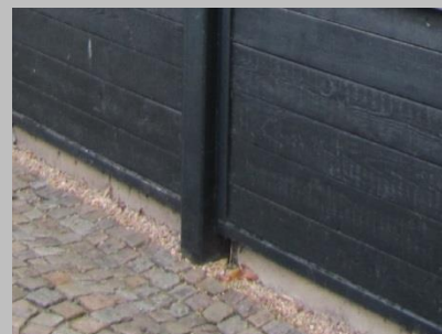
De kantplanken vormen een koudebrug naar binnen
