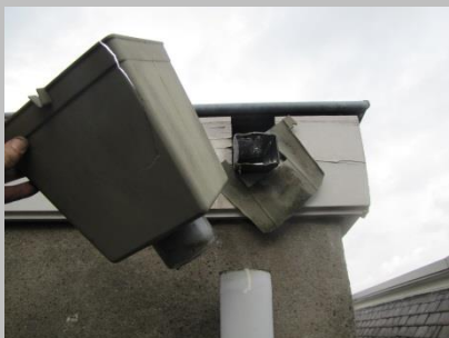
Beschadigde vergaarbak, losse hemelwaterafvoer
