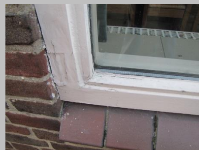
Verzand en uitspoelend voegwerk tussen raamdorpelstenen
