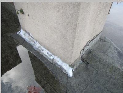
Gaatjes in lood en aanzet bitumen lekkagegevoelig
