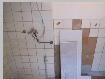
Wandtegels badkamer zijn niet intact
