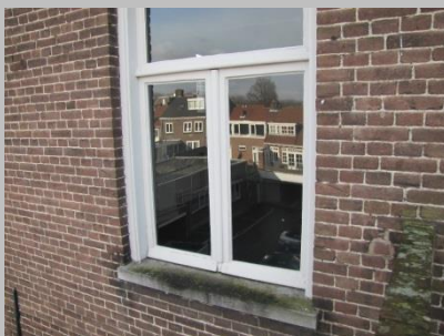
Vuilaanhechting betonnen waterslagen
