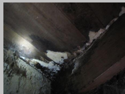
Dakbeschoot en balken bij plat dak zijn rot
