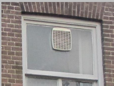
Extra rooster met ventilator in bovenlicht achtergevel
