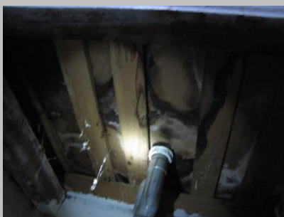
Aftekeningen van lekkage aan de onderzijde
