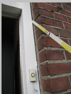
Afdichting langs kozijn niet meer afdoende
