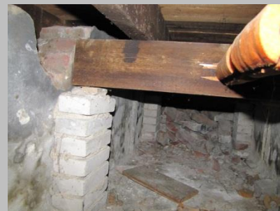
Diverse puinblokkades in de kruipruimte
