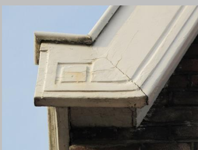
Schade t.p.v. aansluitingen goot- en boeidelen
