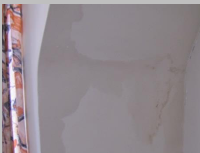
Actieve lekkage naast dakkapel rechter dakvlak
