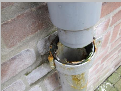
Ontoereikende koppeling hemelwaterafvoer
