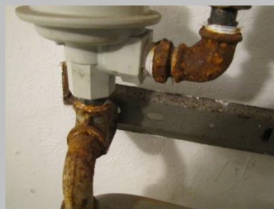
Roestvorming op de koppelingen van de gasinstallatie
