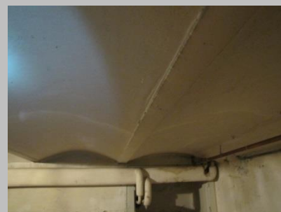
Gerepareerde beschadigingen cq. oude elementbreuk
