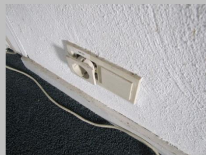
Lokaal beschadigde en/of losse onderdelen
