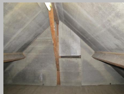
Kap woning deels afgewerkt met asbestverdachte plaat
