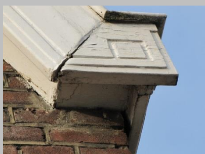
Schade t.p.v. de aansluitingen goot- en boeidelen
