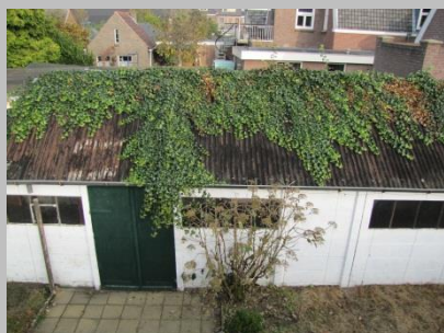
Dakafwerking schuur bestaat uit asbestverdachte golfplaten
