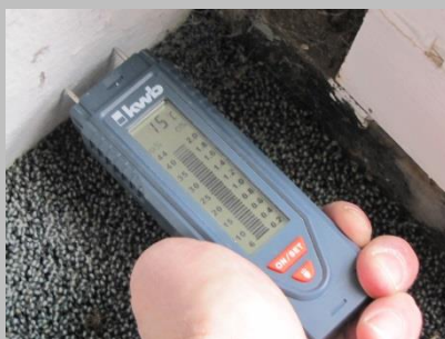
Zacht stucwerk en lokale condensatie
