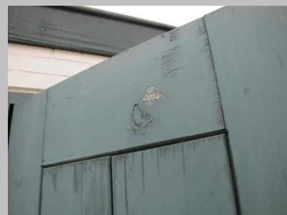
Schilderwerk deur achteraanbouw in slechte staat
