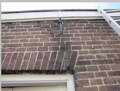
Spanningscheur boven raam onder kapconstructie
