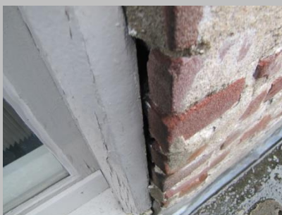
Ontbrekende naadafdichting langs kozijnen
