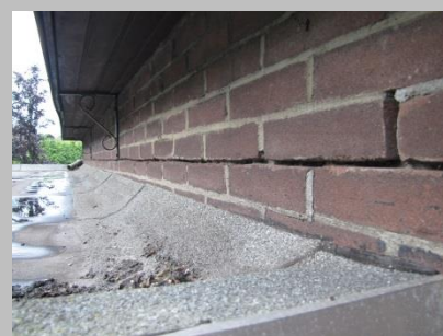
Ontbrekend lood bij aansluiting aanbouw
