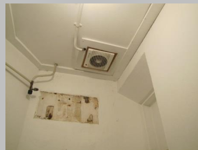
Zelfstandig gemotoriseerde afzuiging in toiletruimte
