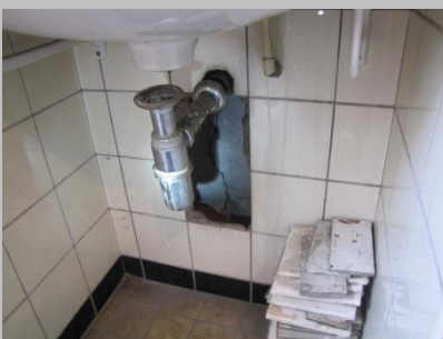
Wasbak los en niet aangesloten op syfon
