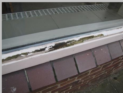
Gevorderde houtrot raam zijgevel
