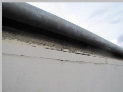
Onverduurzaamde trimplank in het zicht vallend
