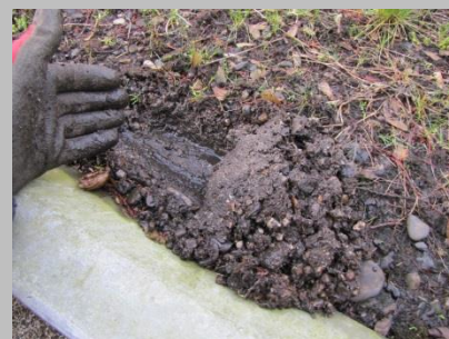
Grinddak vervuild en onvoldoende watervoerend
