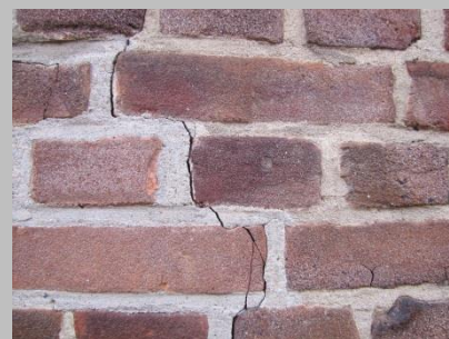
Lokale geringe spanningscheurvorming in de zijgevel
