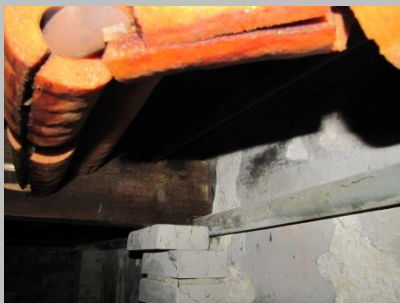
Matige oplegging onderslagbalk en onderbrekingen balk
