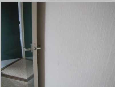
Losse deurekrukken door botsing tegen muren
