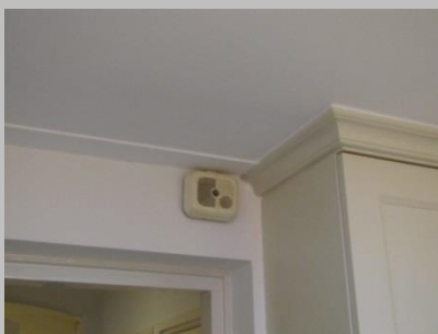
Rookmelder zonder testfunctie verkeerd gesitueerd
