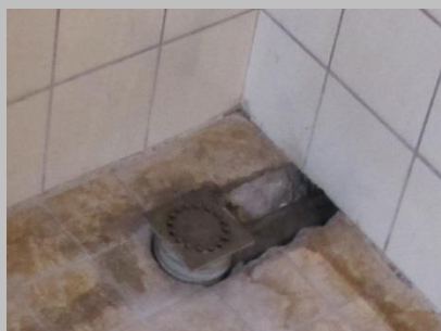
Sleuf doucheputje open, tegel- en voegwerk vervuild
