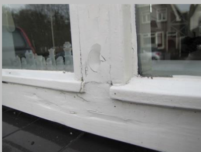
Gevorderde houtrot achter het buitenschilderwerk
