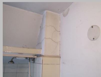
Scheurvorming in de afwerkingen, lasdoos in natte zone
