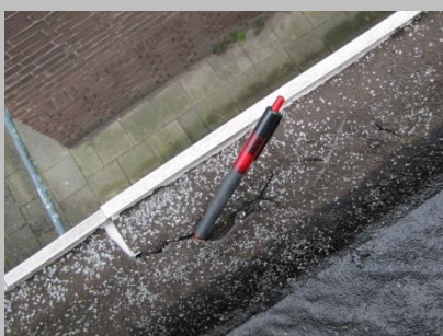
Dakbedekking gescheurd op de randen
