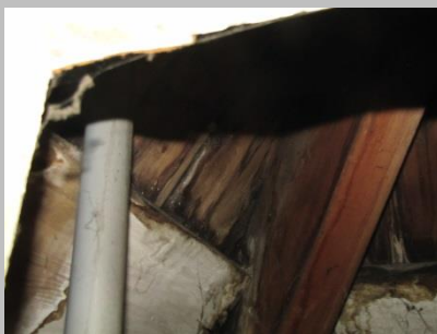
Ontspanningsleiding naar dak
