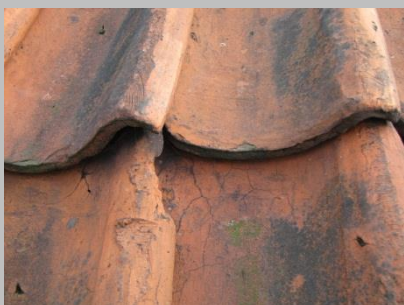
Pannen zijn regelmatig gecraqueleerd en slecht gelegd
