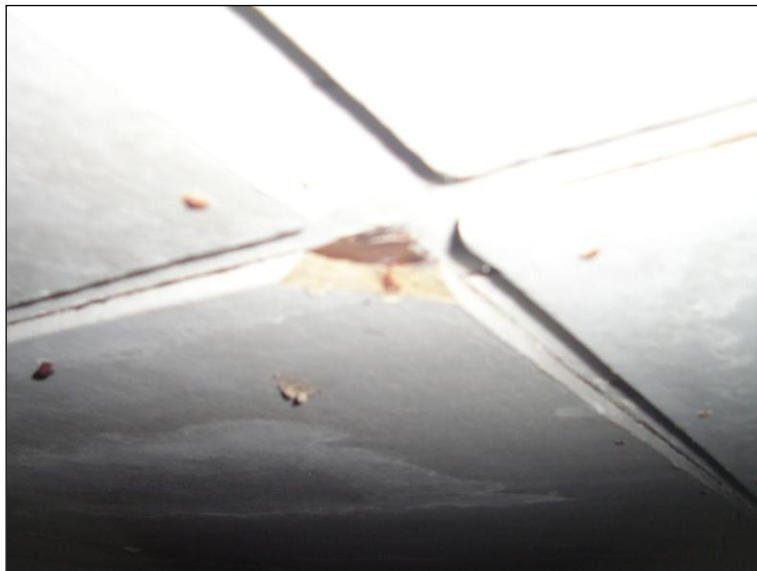
31. beschadigingen aan plafondplaten in techniek
