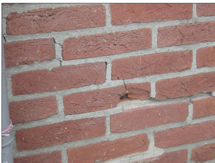
9. gaten en scheuren in buitenmetselwerk
