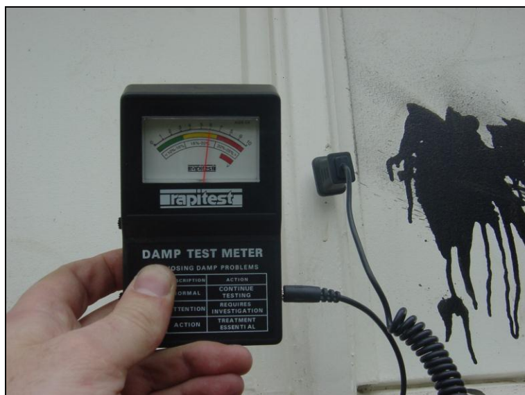
15. kozijnen in achtergevel zijn overmatig vochtig
