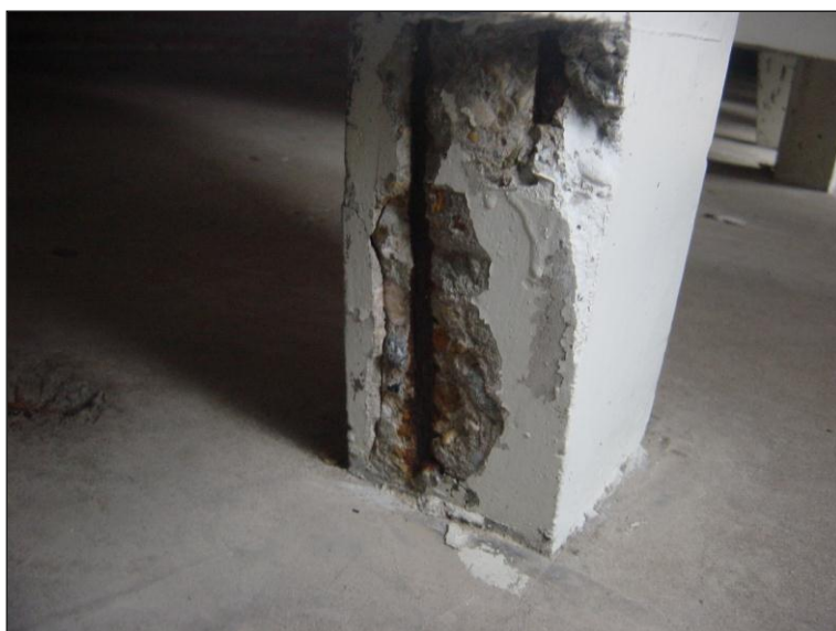
6. betonrot in voetstukken van kleedcabines
