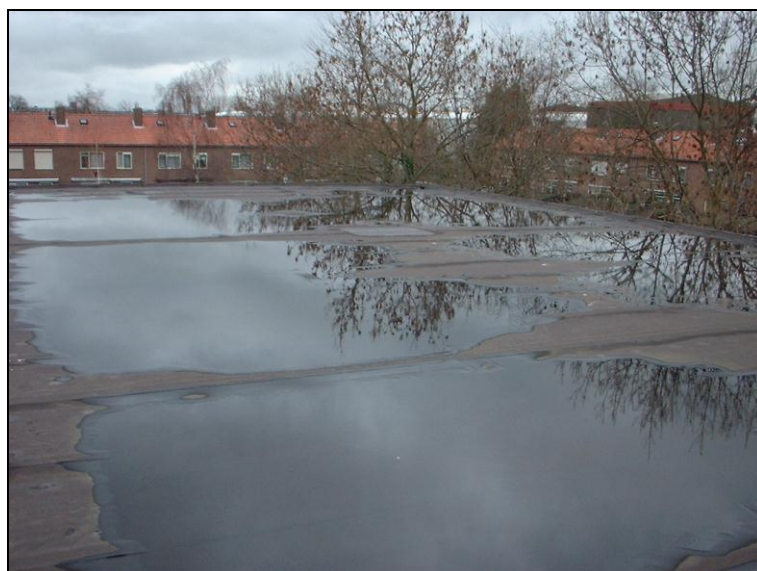
26. geen afschot resulteert in plasvorming
