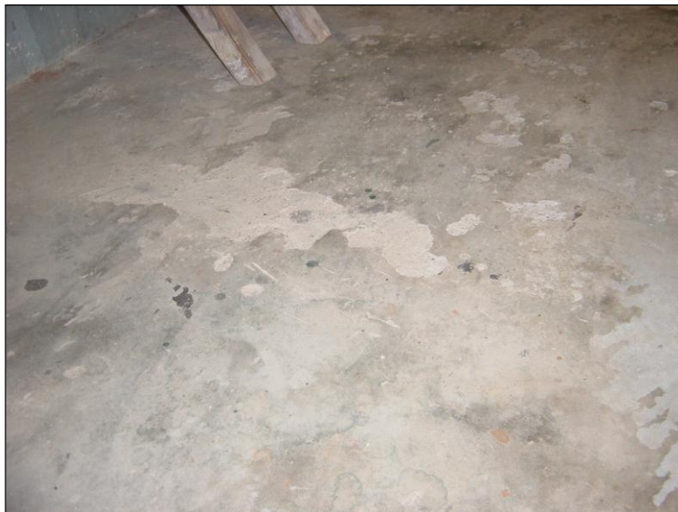
4. beschadigde vloeren in techniek
