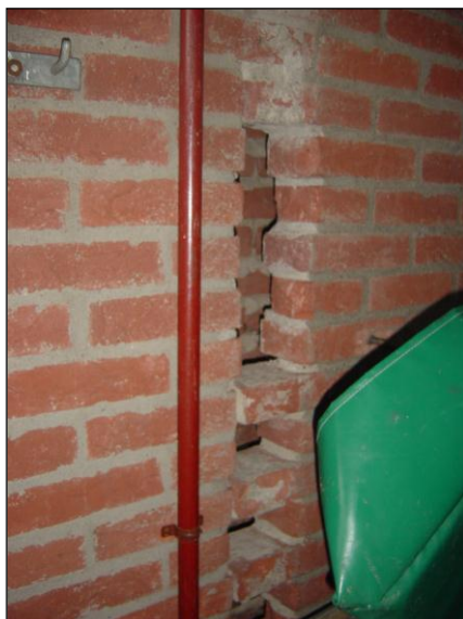
11. gaten in binnenmetselwerk
