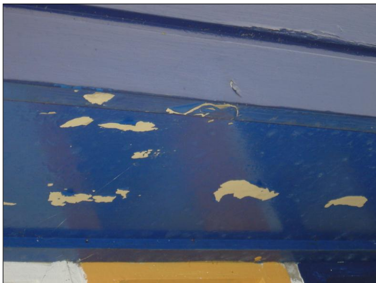
32. achterstallig schilderwerk overstekken
