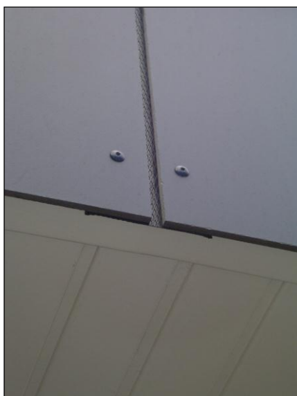
24. DPC-folie gebruikt in plaats van afdichtingsprofiel
