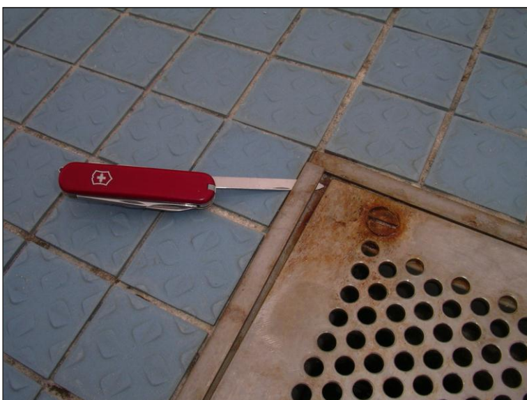
39 gecorrodeerde roosters, losse onderdelen
