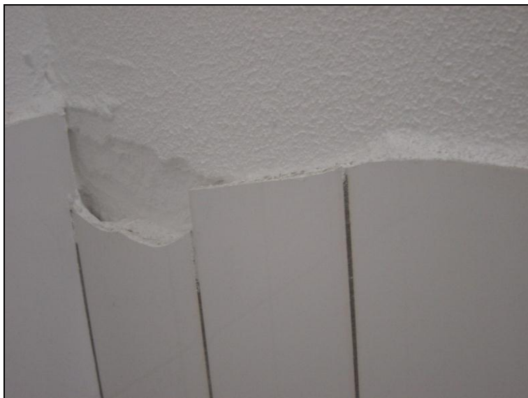
28. beschadigingen aan wandtegelwerk
