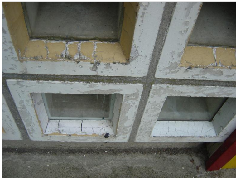
13. beschadigde en slecht geschilderde raamelementen
