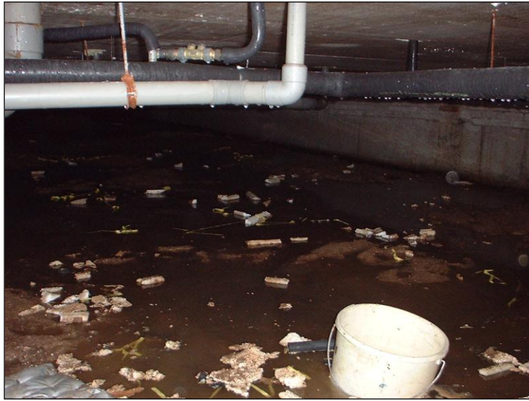
1. hoge luchtvochtigheid in kruipruimte door grondwater
