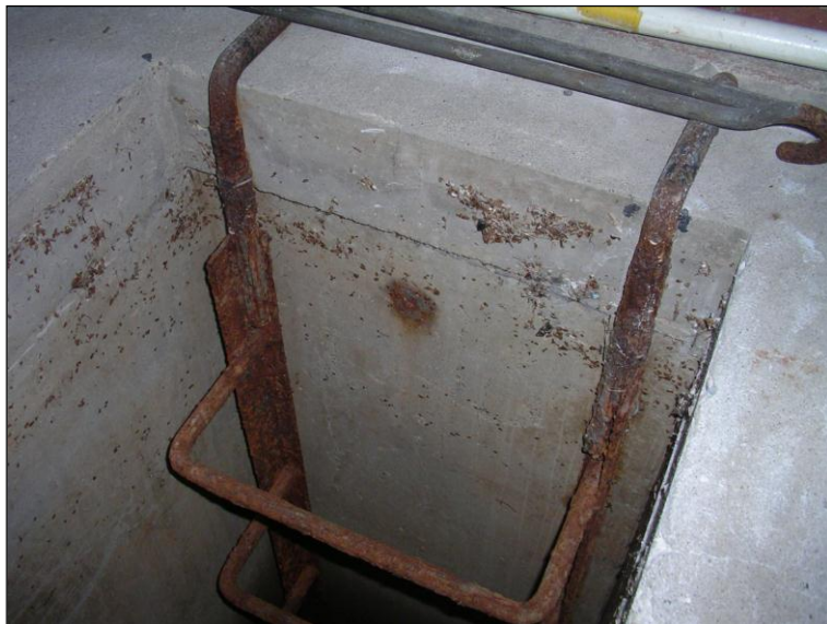
25. inspectietrapje is volledig doorgeroest
