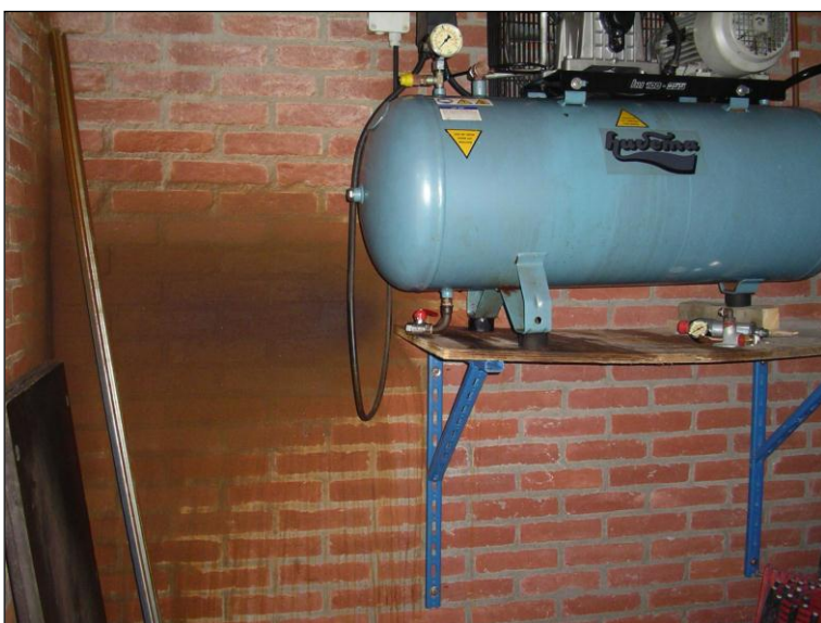
38. binnenmetsewerk blijvend vervuild t.p.v. compressor
