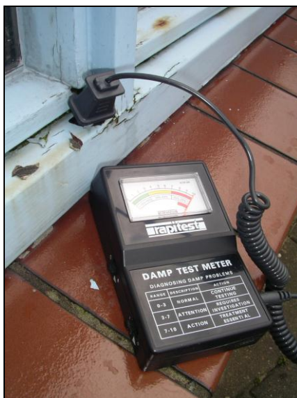
21. kozijn is verzadigd, gevorderde houtrot
