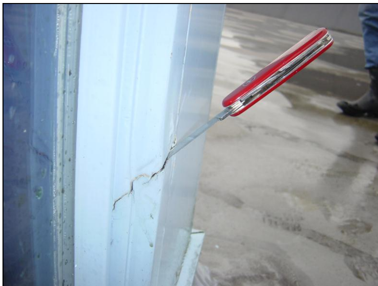
20. kozijn is deels vervangen, scheuren t.p.v. verbinding
