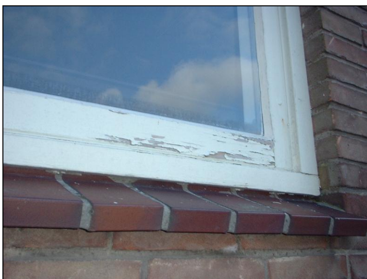
17. schilderwerk buitenkozijnen in matige staat
