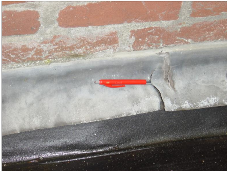
10. voetlood schoorsteen techniek in slechte staat
