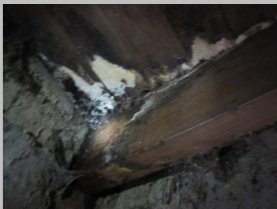
Aangetaste constructie t.p.v. berging
