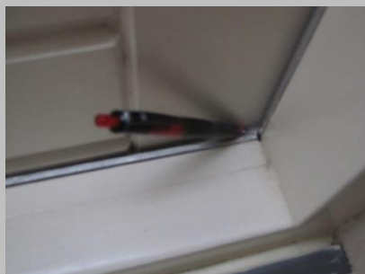
Onvoldoende sluitende deur naar dak
