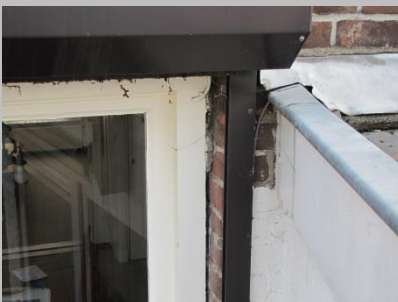
Onvoldoende naaddichtingen langs de kozijnen
