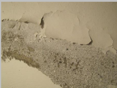
Lokaal afbladderende wandafwerking door oude lekkage
