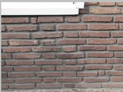
In de linker zijgevel is geringe scheefstand zichtbaar
