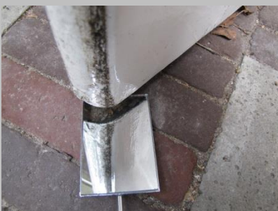
Onderzijde achterdeuren nooit voorzien van verfsysteem
