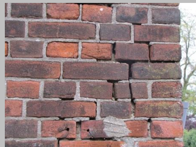
Onvoldoende samenhang metselwerk achtergevel
