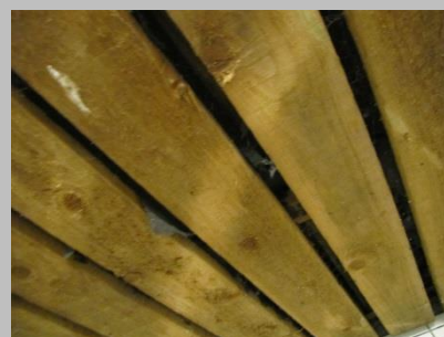
Mogelijk brandgevaarlijk firedoek achter het lattenplafond
