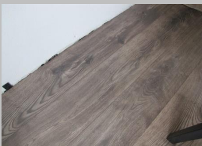
Naden en kieren in open verbinding met kruipruimte
