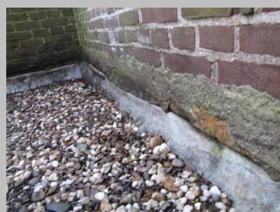
Uitgespoeld voegwerk boven lood, loskomende slabben
