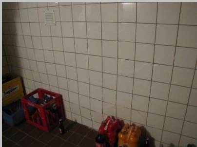
Tegelwerk is weggedrukt van kelderwand
