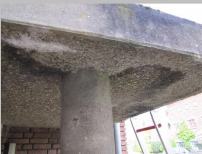
Betonelementen vrijwel geheel ontdaan van de coatlaag
