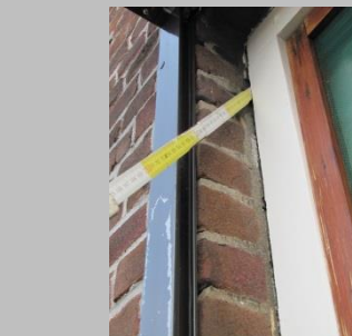
Onvoldoende naaddichtingen langs de kozijnen
