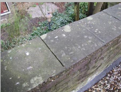
Losgekomen afdichtingen niet elastisch uitgevoerd
