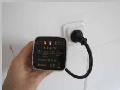
Randaarde niet aangesloten bij wandcontactdoos
