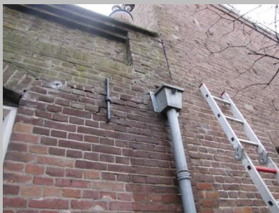
Verhoogde vochtbelasting gevel rond vergaarbak
