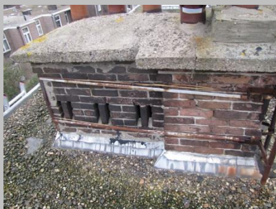
Losliggende en gescheurde betonplaat
