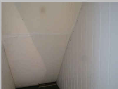
Zachtboard en PVC-schroten niet toegestaan in vluchtroute
