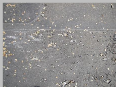
Dakbedekking op balkon gescheurd tot op de inlage
