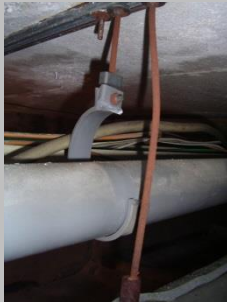
Riolering met tegenafschot door gebroken beugel
