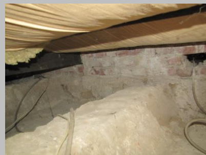
Fundering vanuit kruipruimte beoordeeld in goede staat
