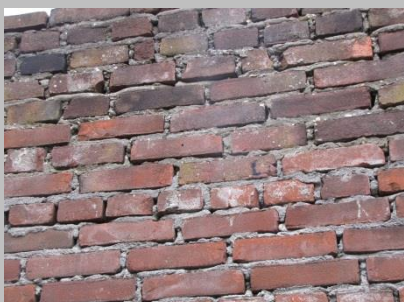
Los en uitgespoeld voegwerk, geringe vorstschade
