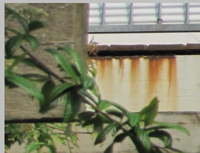
Corroderende randbalk balkon
