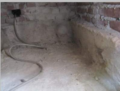
Fundering vanuit kruipruimte beoordeeld in goede staat
