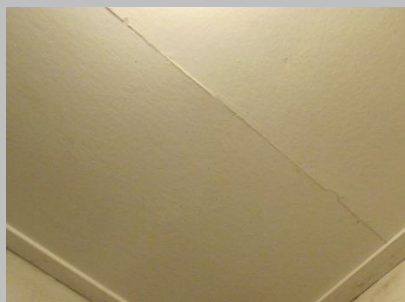
Zachtboardbeplating niet toegestaan in vluchtroute gebouw
