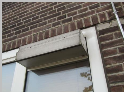
Suskasten in de voorgevels regelmatig reinigen
