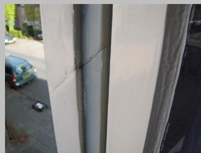
Loskomend lamineer van eerdere reparatie
