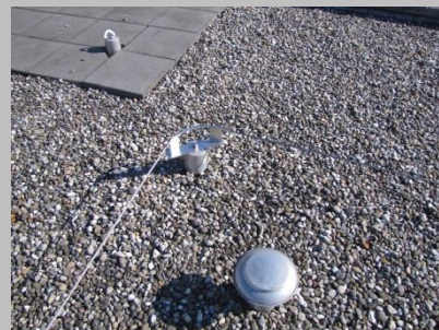
Vering in dak t.p.v. aangetast constructiehout
