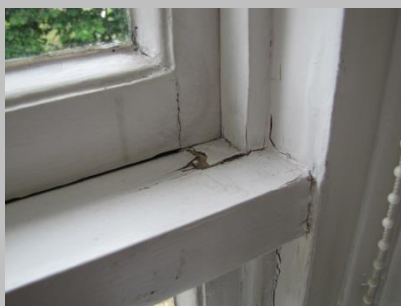
Gedeeltelijk oppervlakkige beschadigingen
