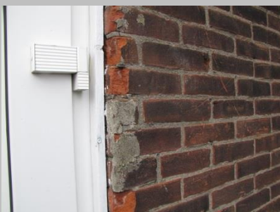
Schade door openen van gezamenlijke balkondeur
