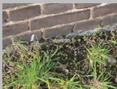
Losse en onvoldoende afwaterende loodslabben
