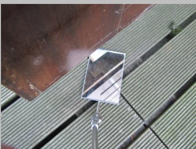
Onderzijde balkondeuren nooit voorzien van verfsysteem
