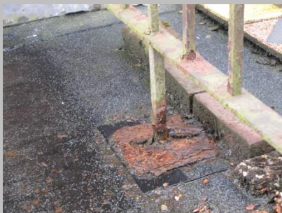
Balustervoeten niet verankerd en volledig weggeroest
