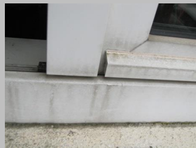
Verkleuring/verkrijting kunststof kozijnen serre
