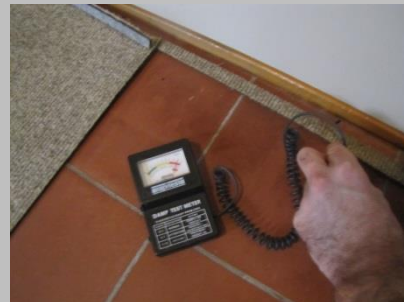
Plaatselijk vocht door de ongeïsoleerde vloer
