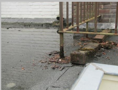
Balustervoeten niet verankerd en volledig weggeroest
