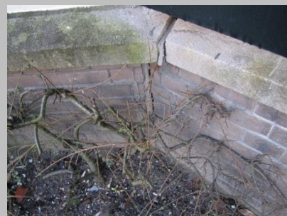
Loslatende afdichting niet elastisch uitgevoerd
