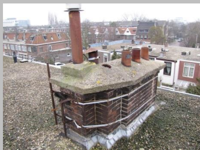
Gescheurde schoorsteen, ontbrekende kraaienkappen
