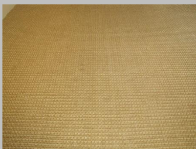
Brandgevaarlijke sisalbekleding in de gangen
