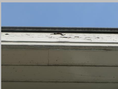
Afbladderend schilderwerk op de dakranden
