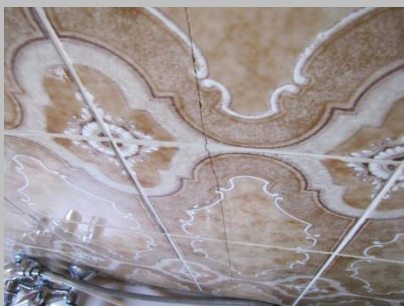
Vertikale scheur door tegelwerk in badkamer
