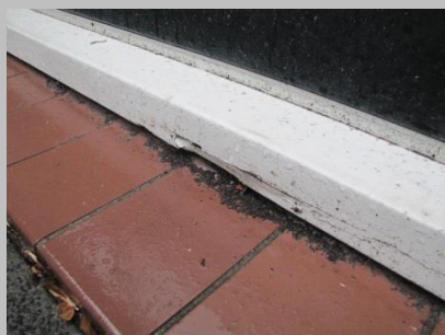
Houtrot door capillair vochttransport bij te strakke plaatsing
