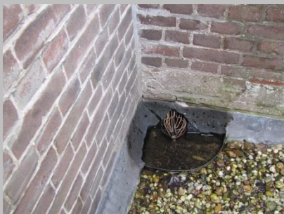
Eerder lekkende afvoer
