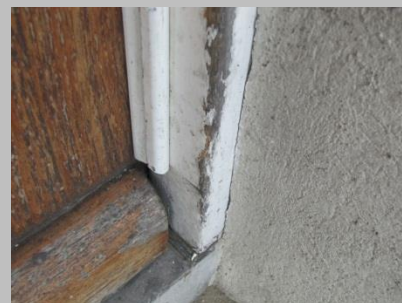
Beschadigde neuten en stijlen t.p.v. voordeuren
