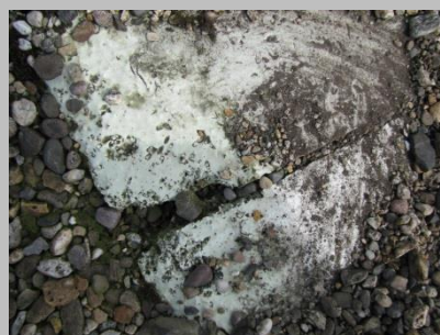
Slechte onderlinge aansluitingen isolatieplaten
