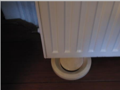
Ventilatie vormt brandlek naar bovenliggend appartement
